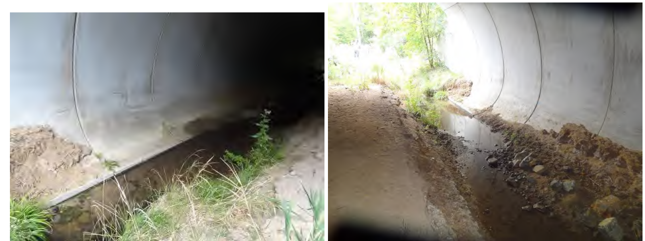
Désordre hydraulique dans l'OH221 (© Egis / D. Ferreira, 2020)
