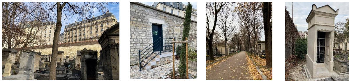
Travaux récents : reprise d'un mur de soutènement, création d'un accès piétonnier, réfection d'enrobés clairs, restauration d'un caveau transformé en columbarium – photos DRIEAT – décembre 2022
