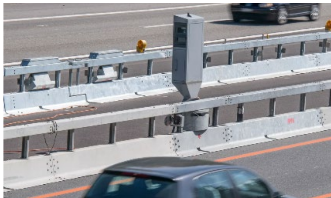
Figure 12 - Radar de chantier en Suisse (source : SIERA)
