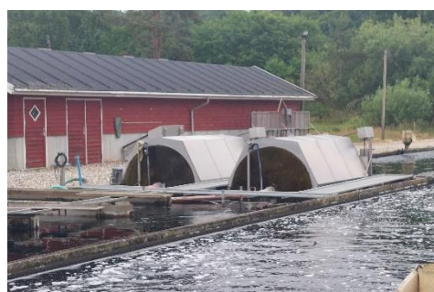
Pisciculture Lofstrup Tambours pour filtration de l'eau
