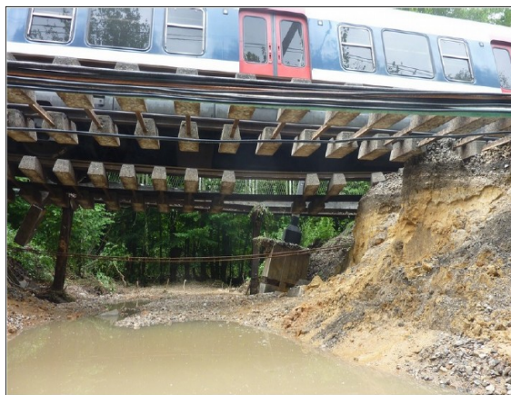
Vue 2 : la rame sur la brèche
