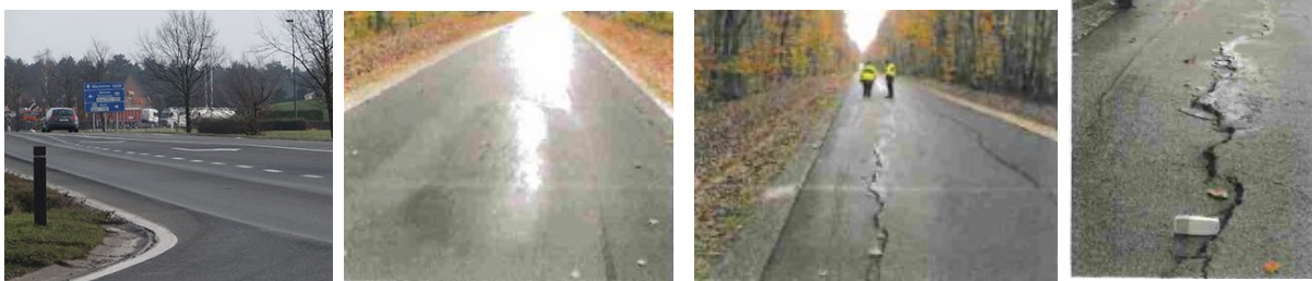
Photos 1 : Orniérage Ressuage de la chaussée Fissuration longitudinale Affaissement en rive (Source : Cerema).
