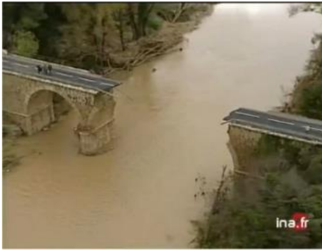
Destruction du pont à Cascastel-des-Corbières
