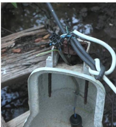
Raccordement électrique en pleine mangrove ...
