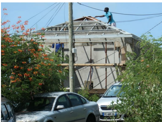
Une construction illégale en pleine construction dans un quartier dont le projet d'aménagement est bien avancé
