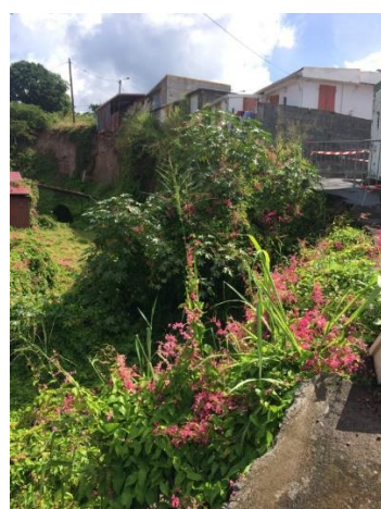
... érosion du talus côté terre,
