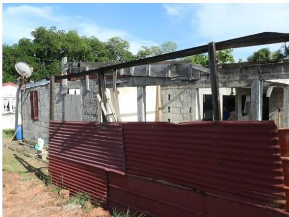
Construction sans permis, de piètre qualité et sans droit de propriété
