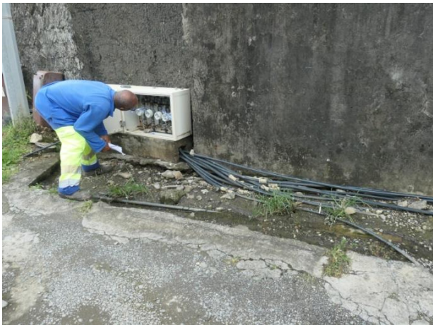
Ici, la collectivité apporte l'eau à l'entrée du quartier. Les piquages individuels courent sur le sol. Trois-Rivières - Grande-Anse (Guadeloupe)
