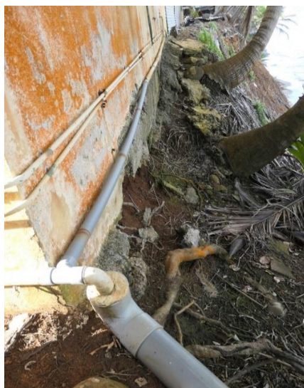
Cette maison menacée par l'effondrement au bord de la falaise ...
