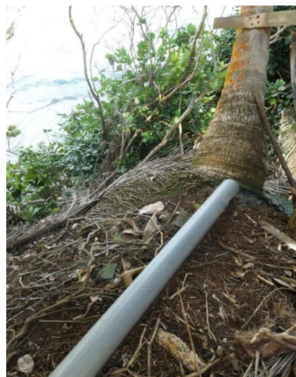
... rejette directement ses eaux sur celle-ci, contribuant ainsi à son délitement !
