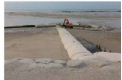
Epi en géotextile à Gouville-sur-Mer (06/12/17) © Thierry Houyel
