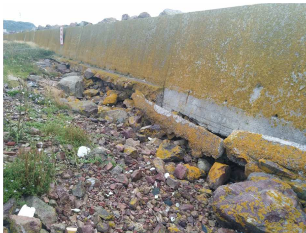
Illustration n° 35 : Digue du Sud-Est, affouillée côté intérieur du mur de crête, Saint-Pierre
