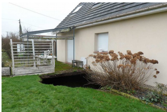
Effondrement sous l'habitation à St-Mards-de-Fresne (Eure, janvier 2018)
