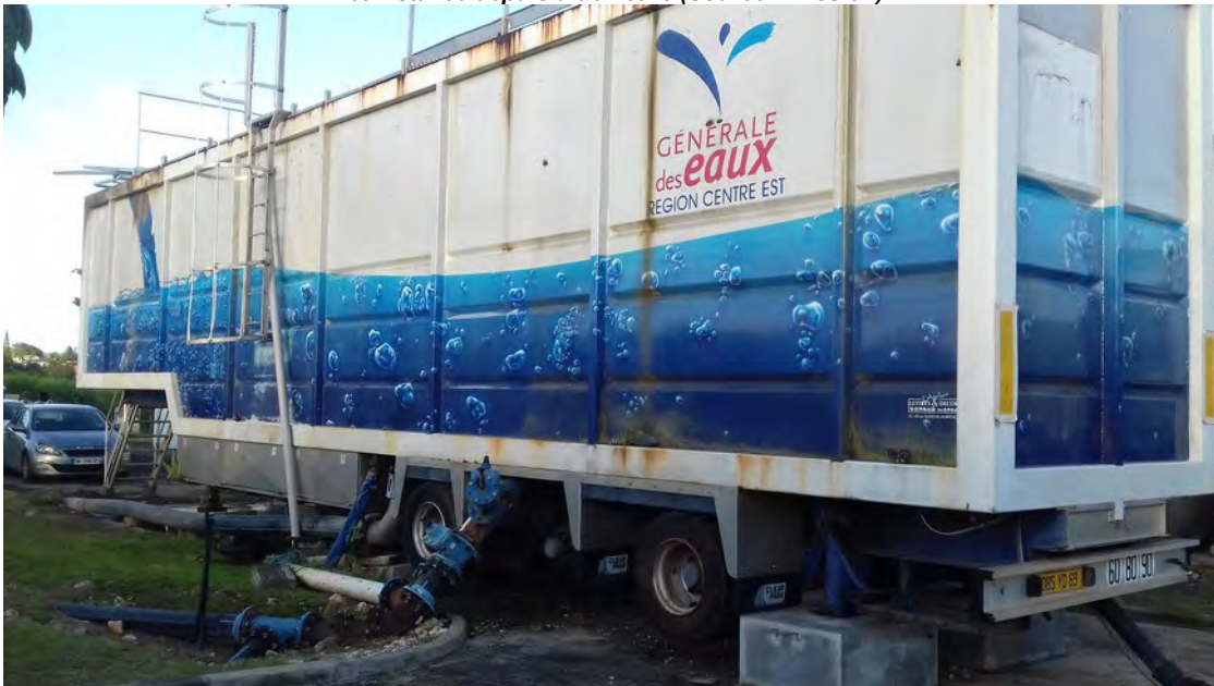
Photo n° 3 : unité mobile de potabilisation venue en appui de la station de potabilisation de Belin et installée depuis à demeure (Source : mission)
