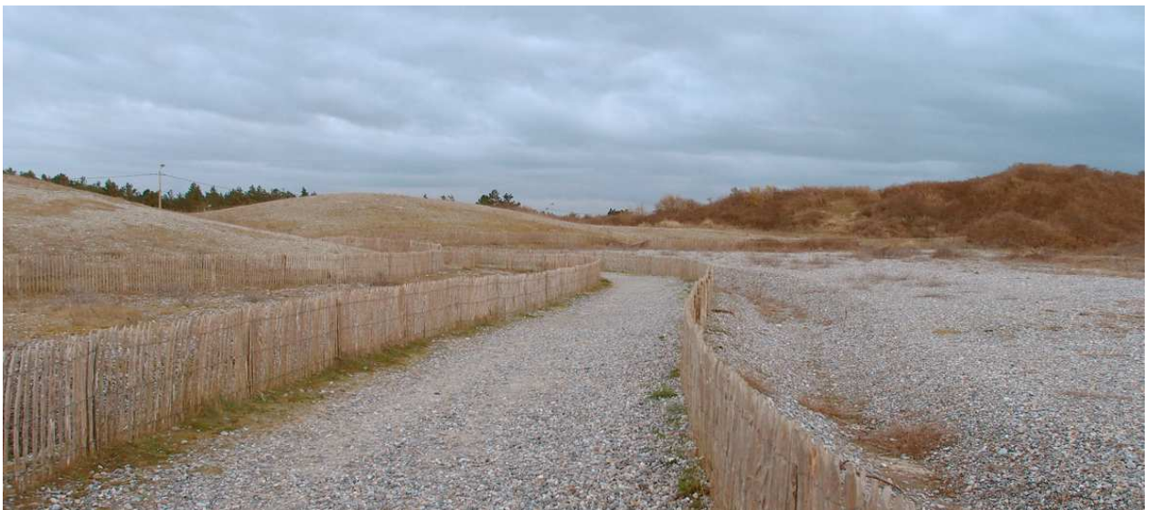
Remodelage du cordon de galets de Cayeux, à l'entrée de la Route blanche (photo JLC)
