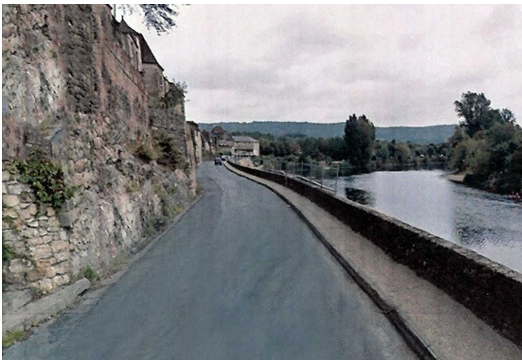
Le secteur le plus étroit, avant aménagement, avec une largeur inférieure à 6 m dont le trottoir, source Google streetview
