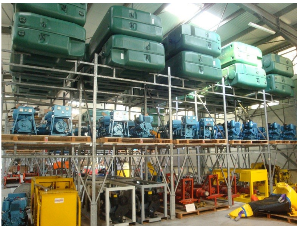
Centre de stockage de Brest : étagères de pompes et réservoirs de produits pollués
