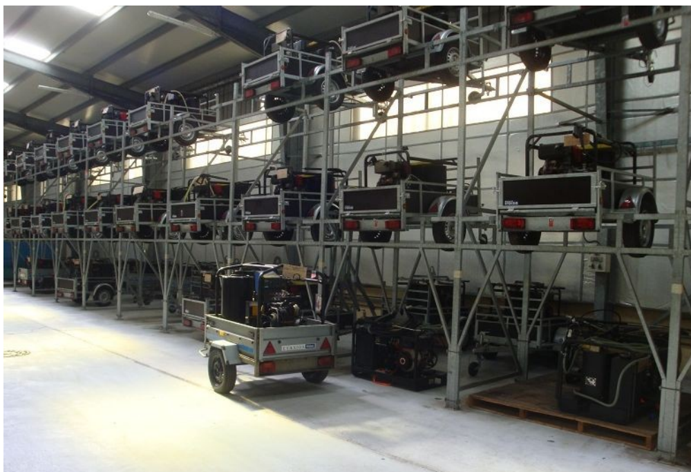
Centre POLMAR/Terre de Brest : Stockage des groupes électrogène
