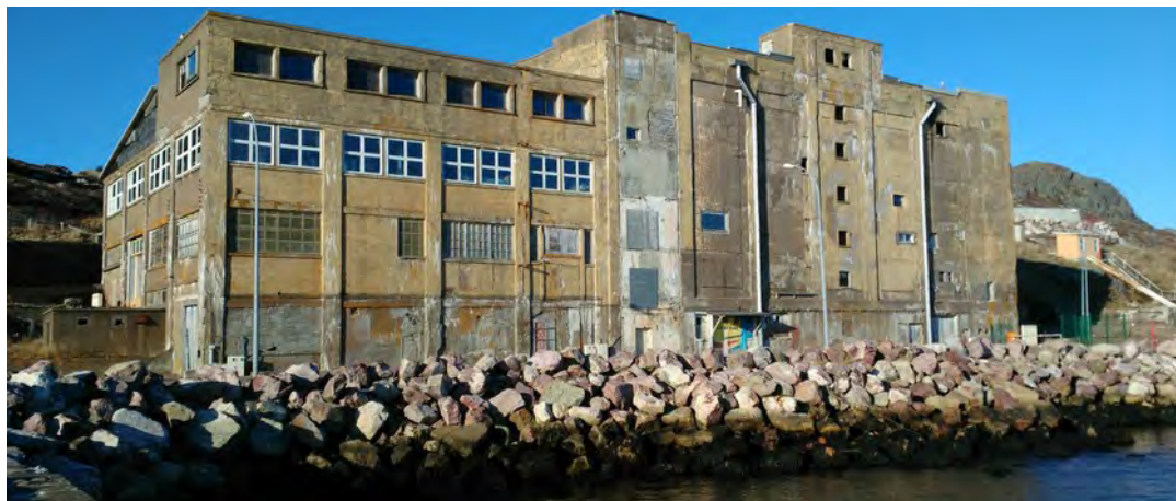
Figure 4 : Le bâtiment de l'ancienne usine frigorifique de la SPEC en béton armé à structure « planchers champignons » (photo : DTAM).
