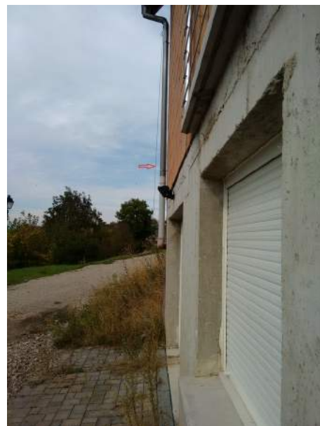
4. Dommages sur une maison moderne (remarque le fil qui sert de « fil à plomb » devant la descente d'eau de la gouttière et indique la gîte)
