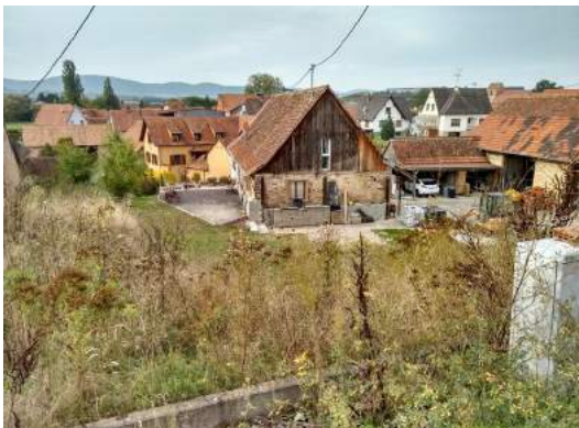
12. Une maison ancienne (fortement endommagée) « protégée » des déplacements horizontaux par un renfort des fondations avec des apports massifs périphériques de béton
