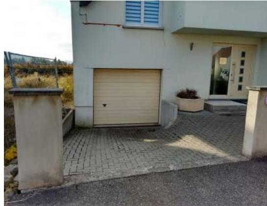
2. L'habitation voisine (fissures et sol très déformé, notamment devant le garage)
