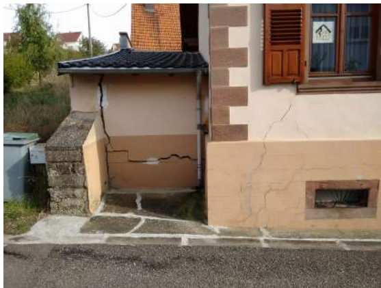
7. Dommages sur une maison ancienne
