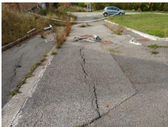
9. Dégâts sur les voies, surrection des réseaux d'assainissement
