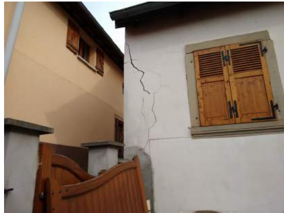
6. Dommages sur une maison ancienne
