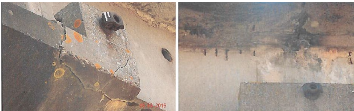
Illustrations 53-54 : fissuration des dispositifs de blocage (53) – aciers apparents (54) – CEREMA
