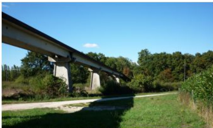
Hormis quelques slogans et peintures diverses, l'ouvrage encore sur pied ne présente pas d'anomalies visuelles agressives. L'intégrité de la structure est quasiment intacte.
