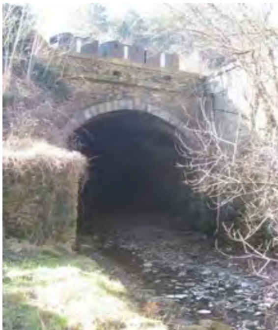
Ruisseau couvert de La Valette (253 ml- Robiac-Rochessadoule) Source : École des mines d'Alès
