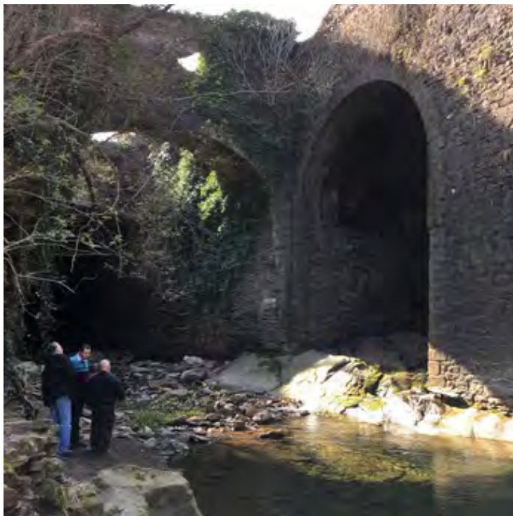
Confluence des deux ruisseaux couverts voûte effondrée sur l'Oguègne 1 et mauvais état du subsistant (photo mission)
