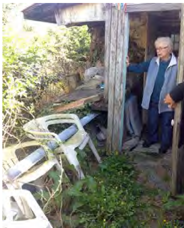
Affaissement d'une terrasse au 409 (photo mission)
