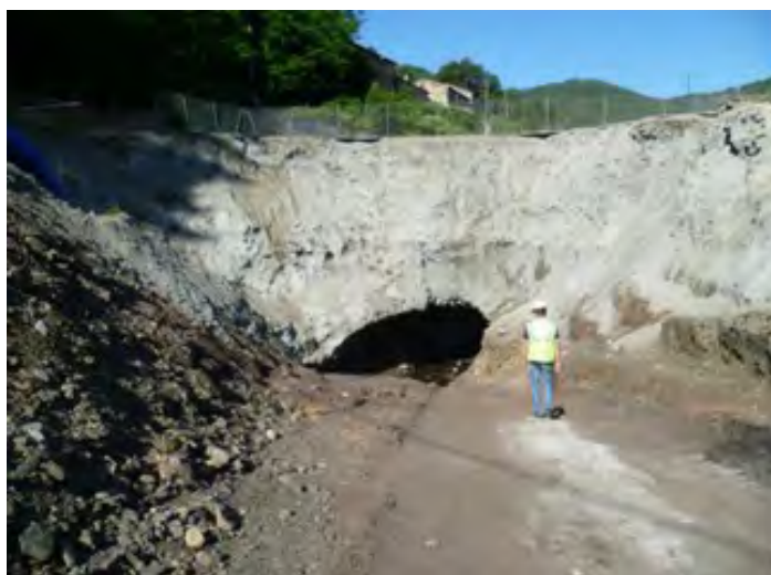
Quelques mois après l'effondrement du ruisseau couvert du Rieusset à Robiac-Rochessadoule Source : mairie de Robiac-Rochessadoule
