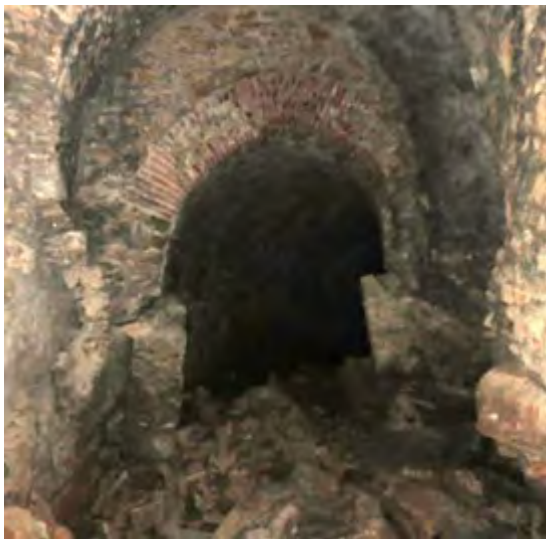
Bombement, affaissement des piédroits. Déstabilisation de la voûte en cours (Galerie « Forge » à Bessèges) source 4 photos : Antea Group – CC Cèze Cévennes
