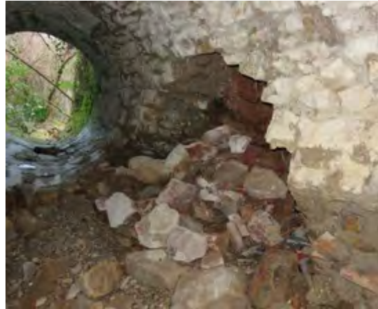
Absence d'éléments constitutifs du revêtement : localisé ou départ par panneaux (Galerie « Forge » à Robiac)
