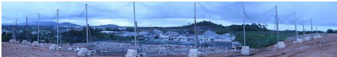
Illustration 8 : Filets de protection sur la décharge des Maringouins près de Cayenne
