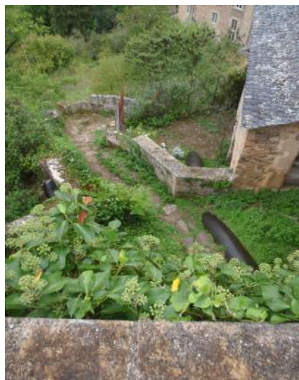
Photos 3 et 4 : conduite forcée, clichés mission
