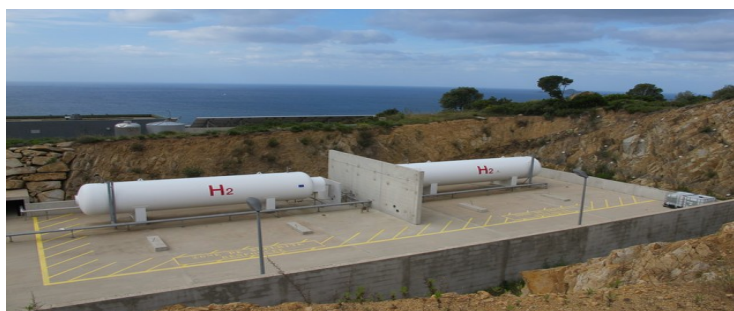
Figure 42. Les deux réservoirs d'hydrogène
