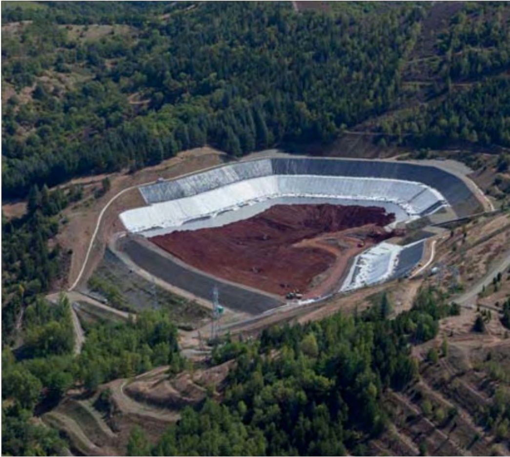
Vue aérienne de l'alvéole de stockage (présentation de l'agence Adour-Garonne lors de la journée cadmium en 2014)
