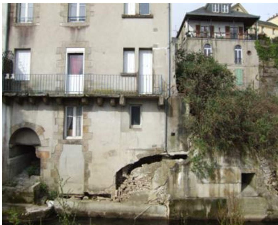
Photo 2 Suite au diagnostic du CEREMA, cette maison fissurée au moment de la tempête Dirk a été évacuée pour raison de sécurité
