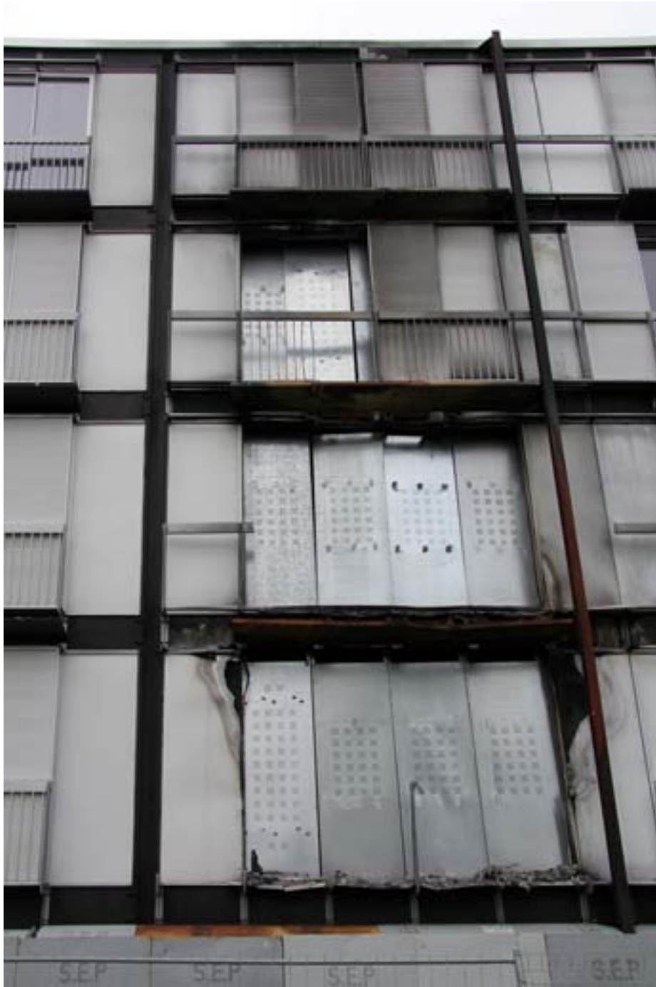
L'état de la façade après l'incendie du premier étage de 2011.
