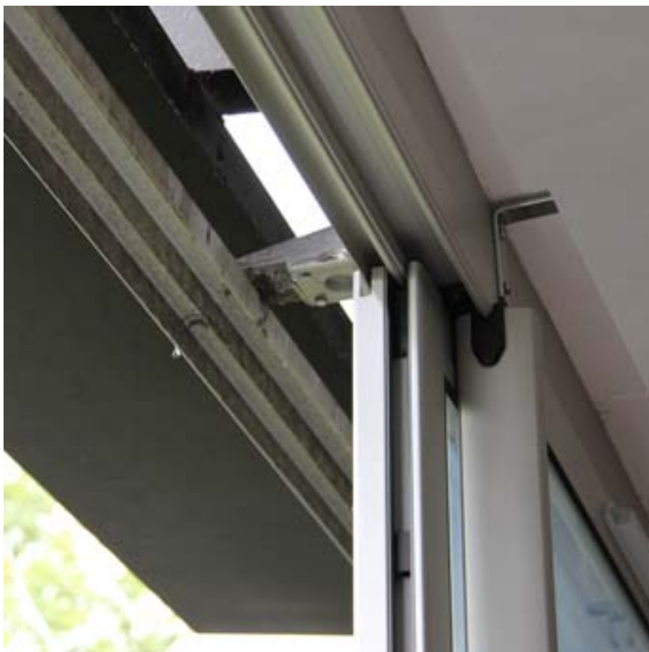
La Grand'Mare. Une photographie prise en contre-plongée d'un détail des menuiseries et de la casquette de façade. On voit, à gauche, la face inférieure de la casquette introduite en 1982-83 pour obtenir un début de "C+D", ainsi que la glissière haute des menuiseries coulissantes.
