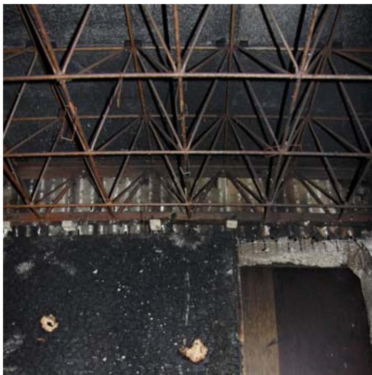
La cloison de séparation des logements. Le feu ne l'a entamé qu'en surface, provoquant un phénomène de pyrolyse.
