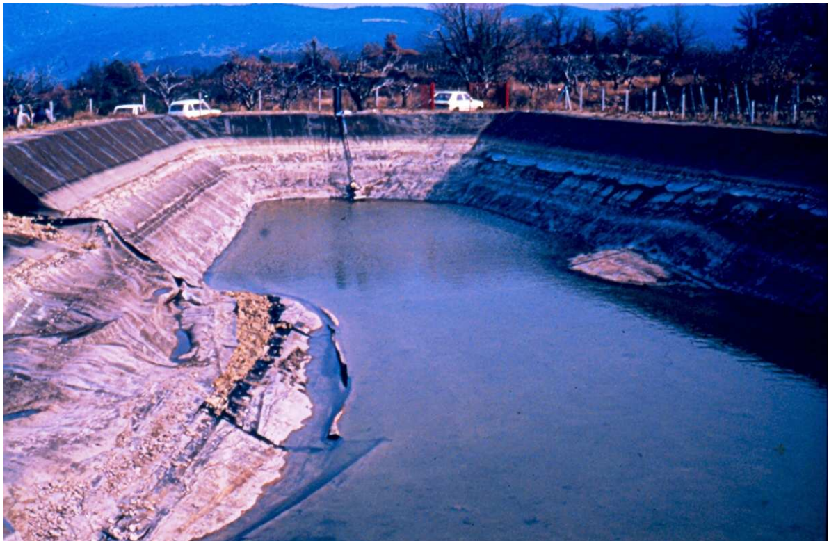
Illustration 1: Glissement de talus d'un bassin étanché par géomembrane
