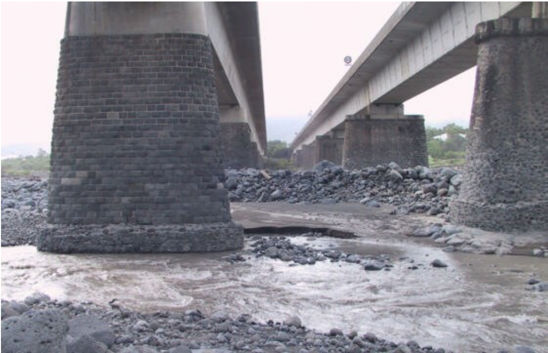
Photo 19 : Pile P7 aval après DIWA
