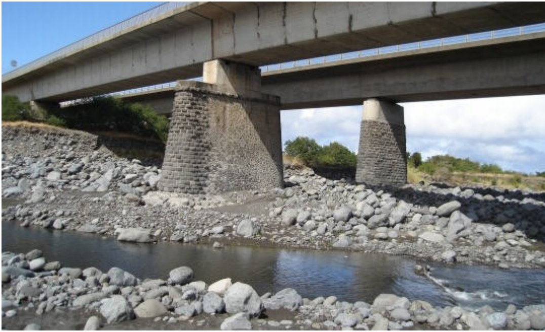
Photo 19 : Piles P8 amont et aval après DIWA
