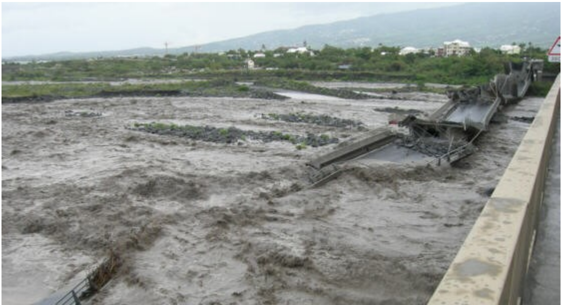
Photo 6 : Vue vers la rive droite à l'emplacement de la pile P7 disparue
