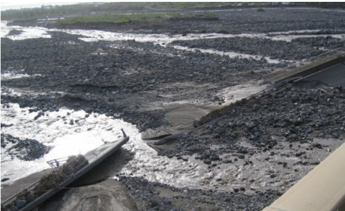
Photo 8 : Vue de l'emplacement de l'ancienne pile P7 après décrue
