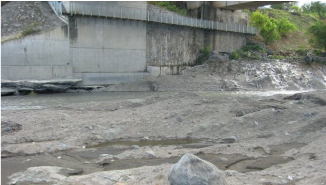
Photo 20 : Vue de la coulée boueuse entre C1 et P2
