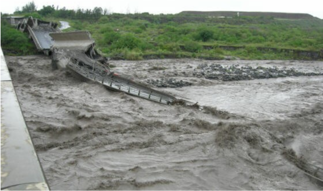
Photo 7 : Vue vers la rive gauche à l'emplacement de la pile P7 disparue
