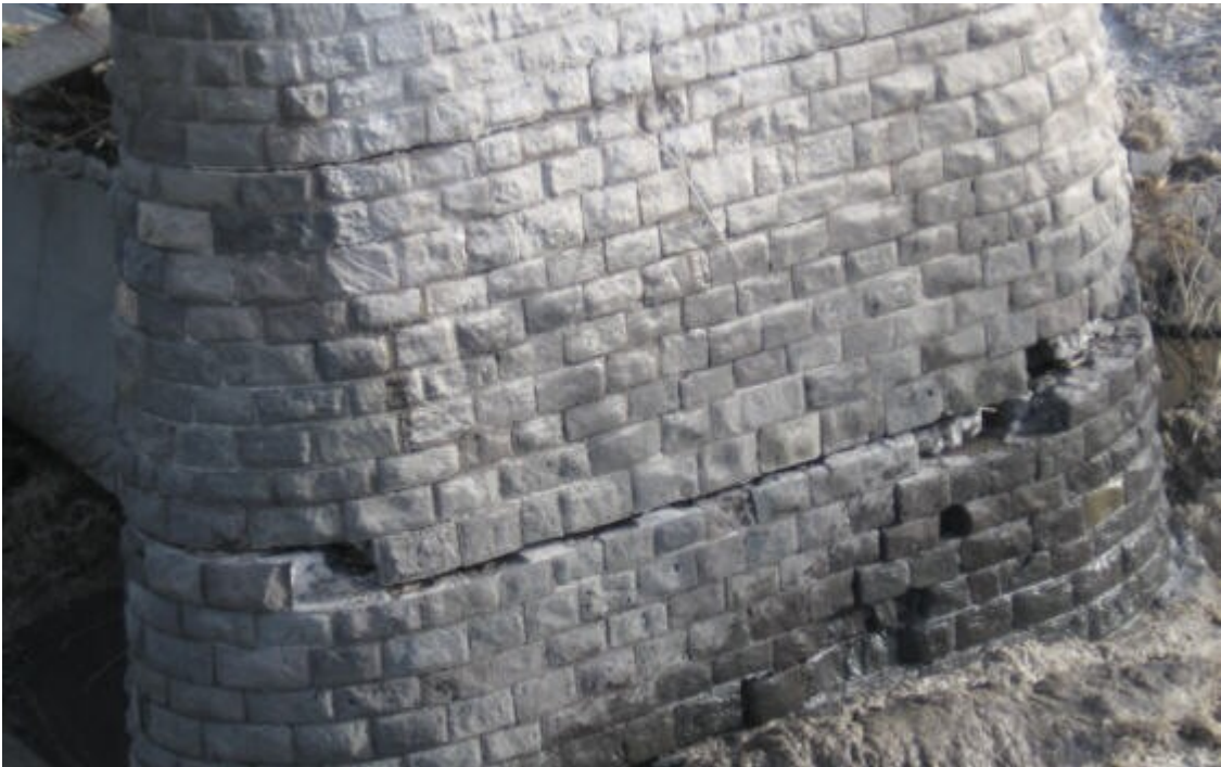
Photo 10 : Vue de la pile P4 fracturée
