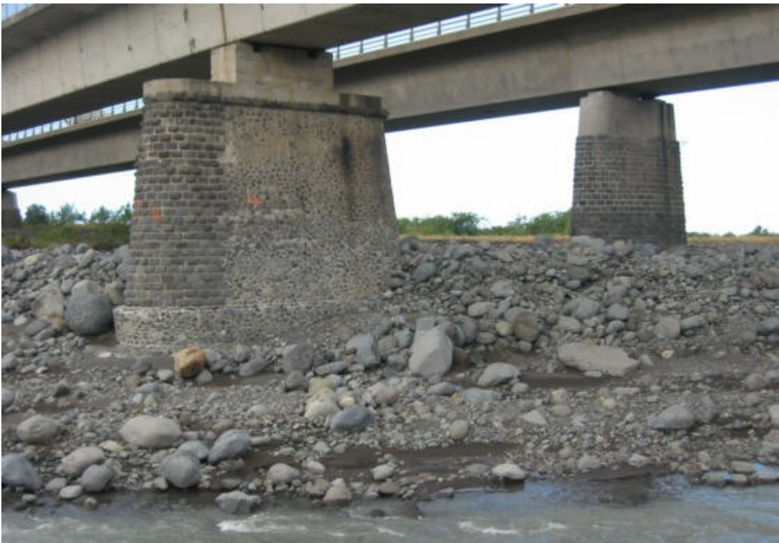
Photo 14 : Vue des piles P7 amont et aval après DINA
