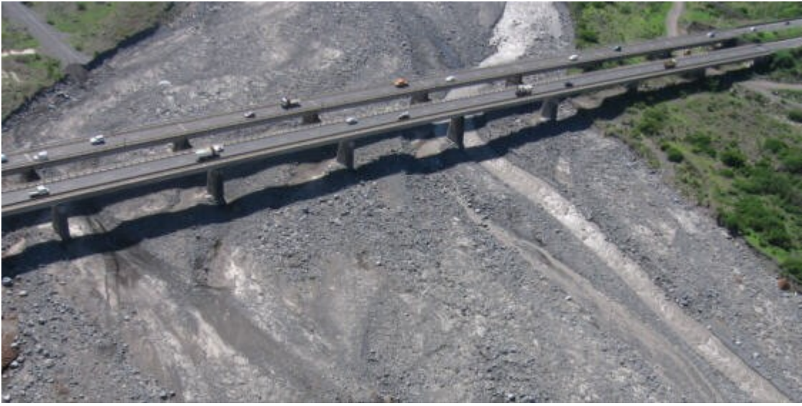
Photo 13 : Vue aérienne après passage de DIWA
