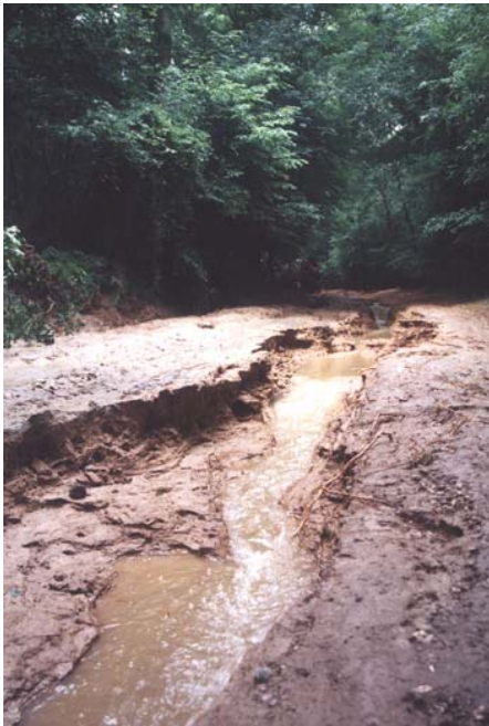
Voirie défoncée dans le talweg sec
