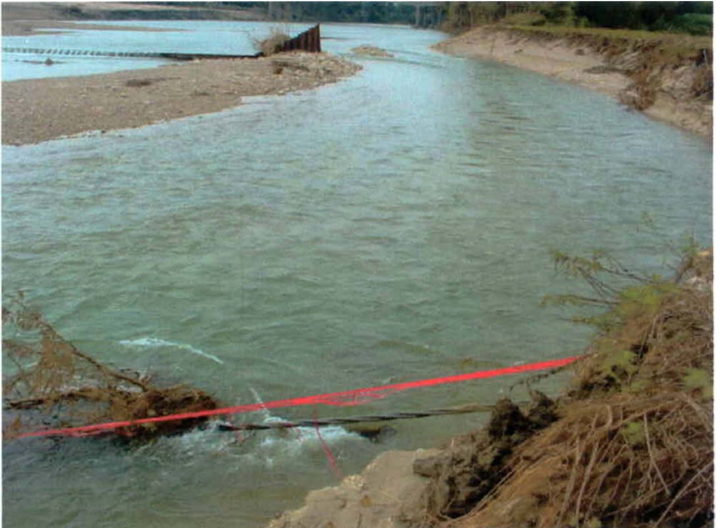
Câbles électriques déterrés après la crue
